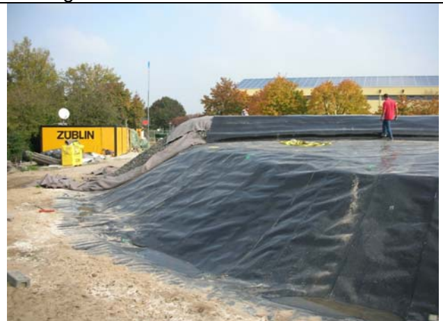
Aufbau der Deckeldämmung aus Schaumglas-schotter auf innerer Lage Kunststoffbahn. Abdeckung der Wärmedämmung mit äußerer Kunststoffbahn
